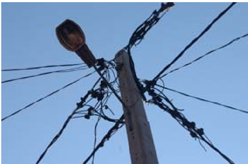
Gegensätze: Uralte Verkablungen, moderne Strassenlampen...
